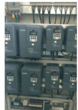
Система очистки воды
